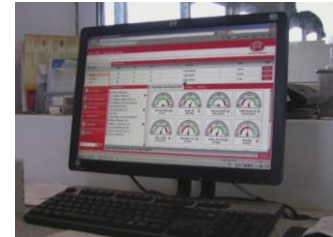
PC i teknikrummet
